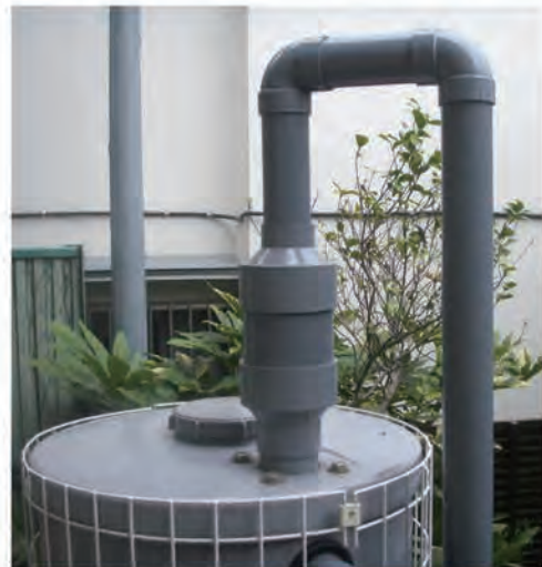
管口浄化フィルター
