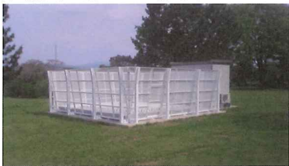
図1 福井工業大学のWPRの屋外アンテナ部
